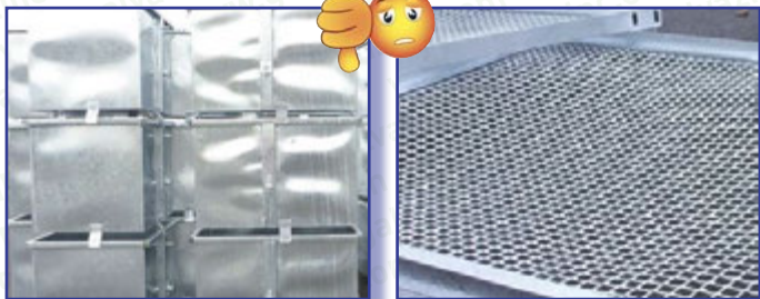
Photos 44 et 45 : Déformation de tôles fines ou de grillages
